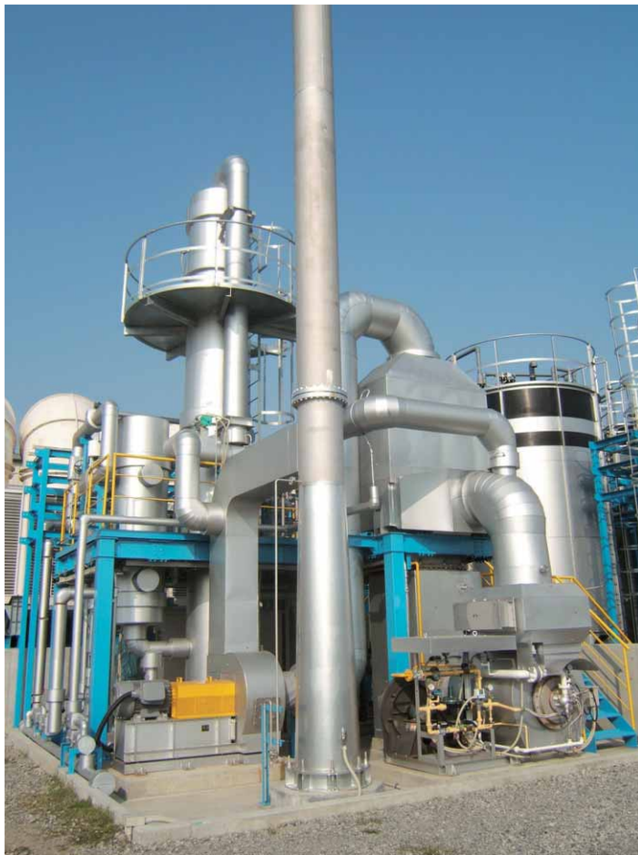
アンモニアガス分解システム
