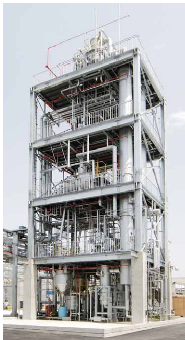
溶剤回収装置
