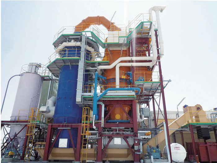
プラント外観
