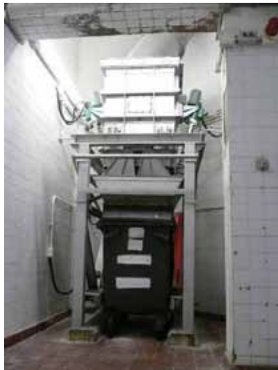
高層ビルごみ収集システム(バンカー)
