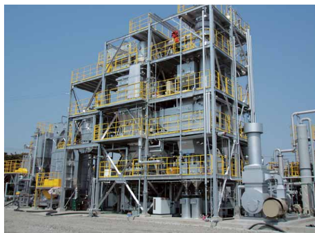
下水汚泥ガス化発電実証プラント
