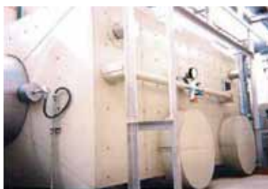
SCR脱硝装置反応器 外観
