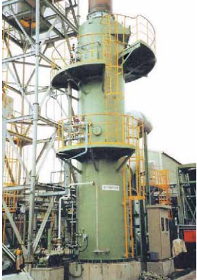
脱硫装置外観
