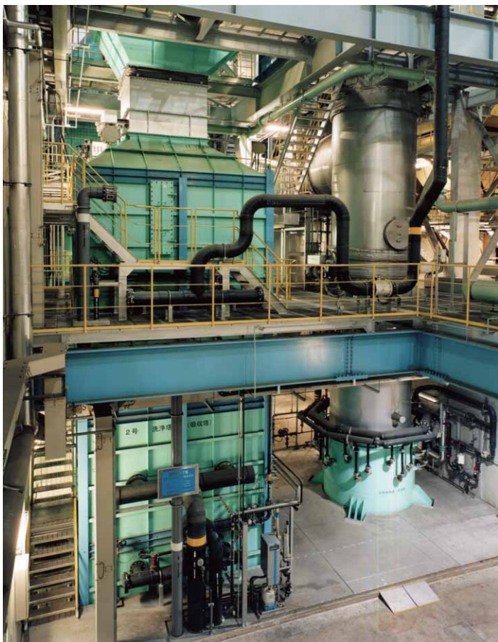
GREATS都市ゴミ焼却炉有害ガス除去装置
