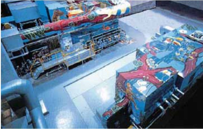
堺市クリーンセンター東工場第二工場発電機室
