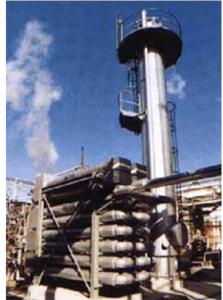
エチレンプラント向けシステム外観
