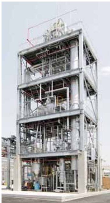
溶剤回収装置
