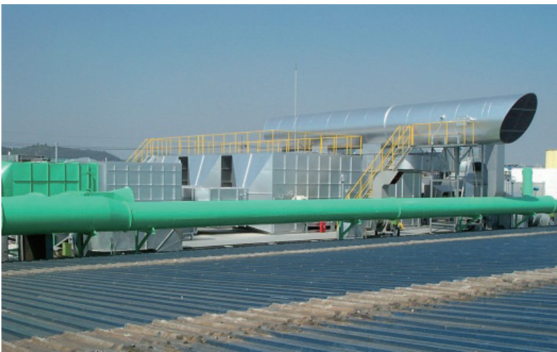
大型脱臭装置
